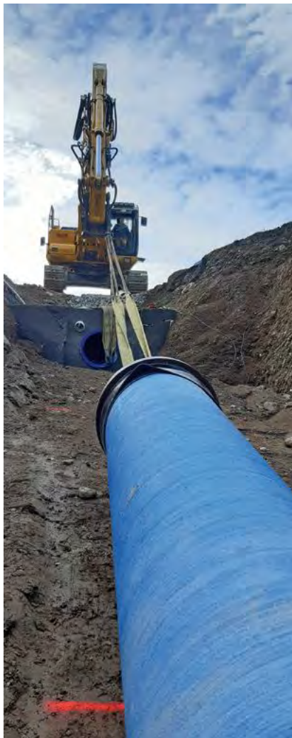
Die Kraftwerksleitung muss eine Höhendifferenz von 650 Metern überwinden: Die BLS-Verbindung hält.
