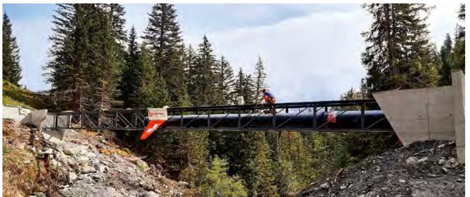
Die rund 30 Meter lange Rohrbrücke, bestehend aus Kurzrohren DN 600. Diese sind mit HDPE-Isolation geschützt, damit das Wasser an solch exponierten Lagen nicht gefriert.
