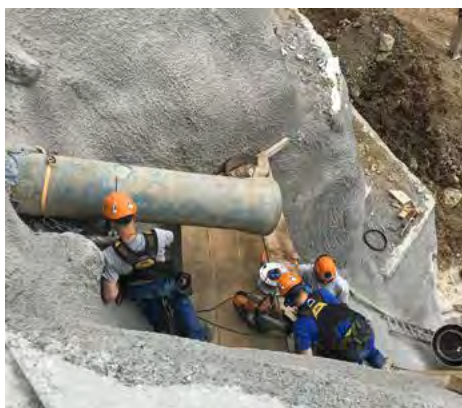
Rohrschnitt unter erschwerten Bedingungen im Steilhang, damit die neuen Bogen angebracht werden können.
