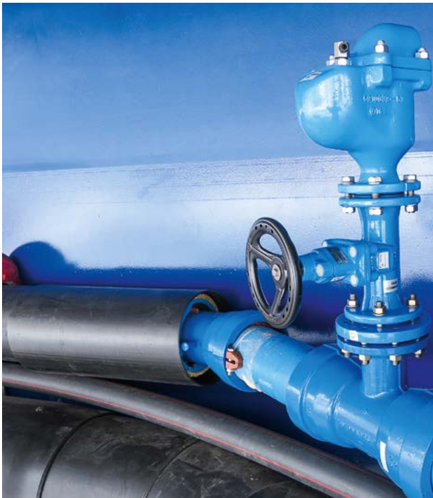
Hochpunkt an der Reussbrücke. Das Be- und Entlüftungsventil Twin Air löst dieses Problem auf einfache Weise
