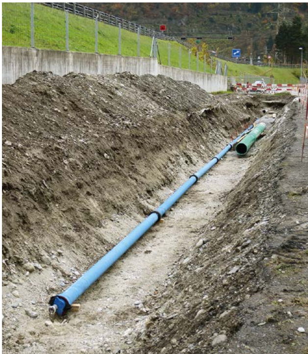
Neben der neuen Trinkwasserleitung wurde in Teilbereichen auch noch eine Abwasserdruckleitung mitverlegt.
